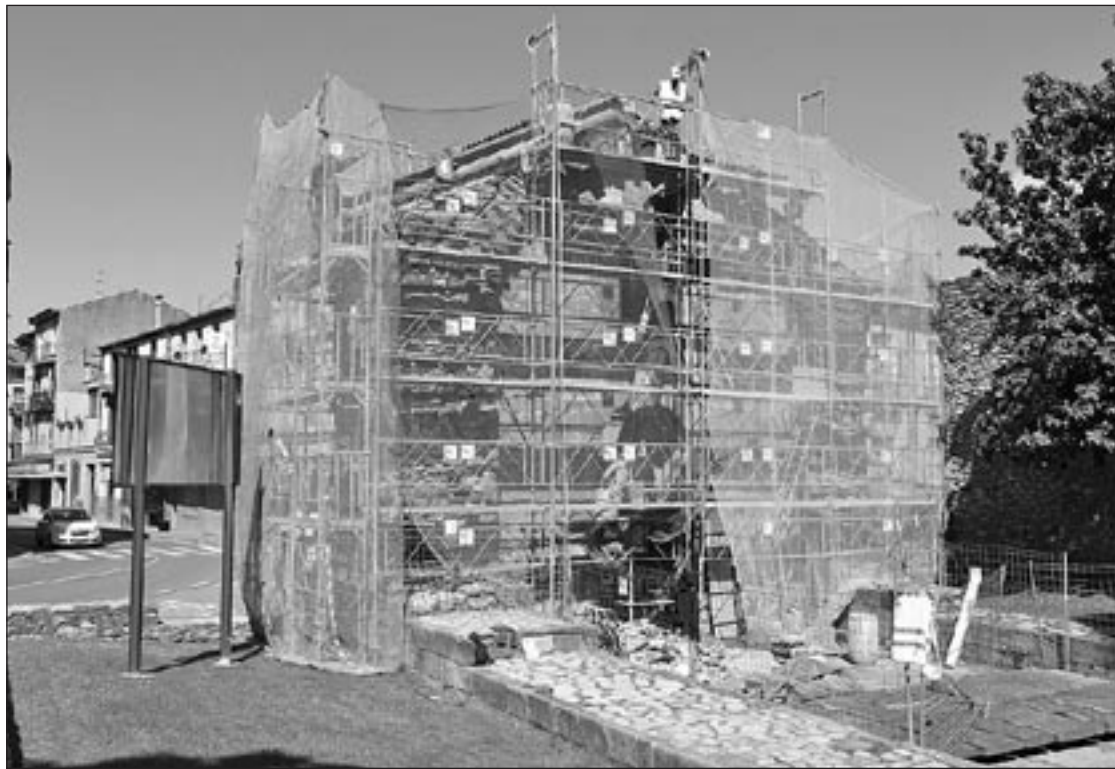
Aspecte posterior de la façana de Sant Pol, a l'inici dels treballs de restauració
